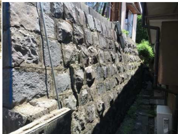
熊本地震被災直後状況
