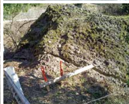
<上>施工前状況 <下>施工前亀裂部状況
